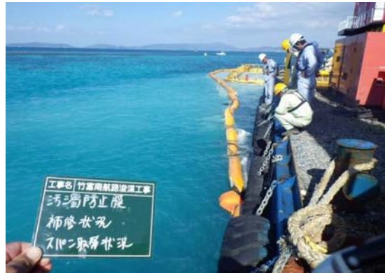
汚濁防止膜破損による濁りの状況
