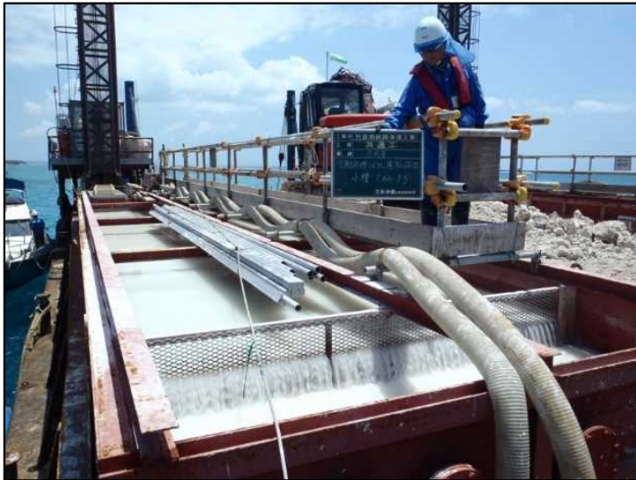
沈殿処理システム
