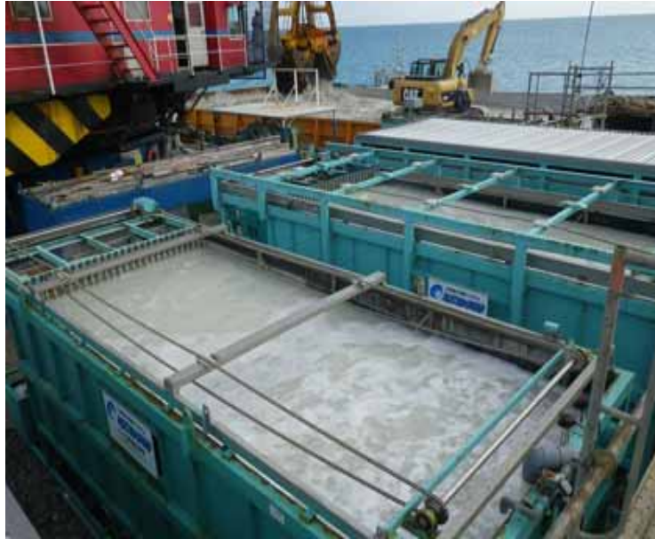
写真 2.3 濾過処理システムの稼働状況
