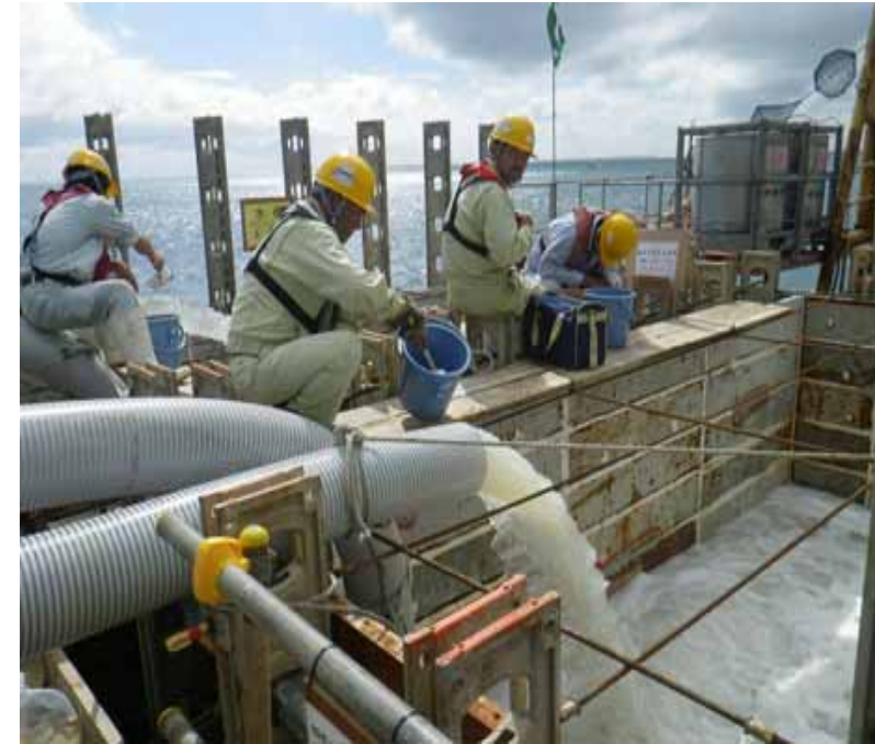
写真 2.5 凝集剤の投入状況
